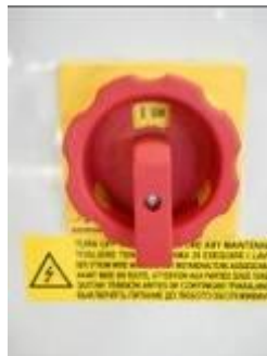
Figura 16 – Interruttore generale su ON
