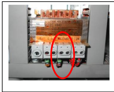
Figura 5 Trasformatore impostato a 400 V
