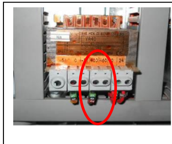
Abbildung 5 Auf 400V eingestellter Transformator
