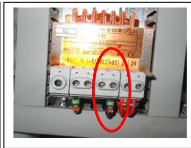
Abbildung 6 Auf 460V eingestellter Transformator
