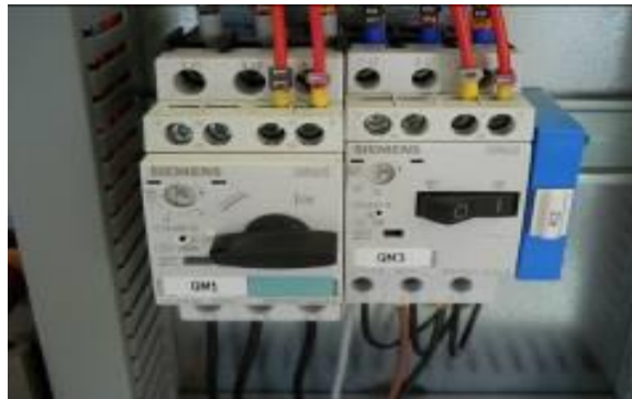
Figura 15 – Interruttore della pompa su ON
