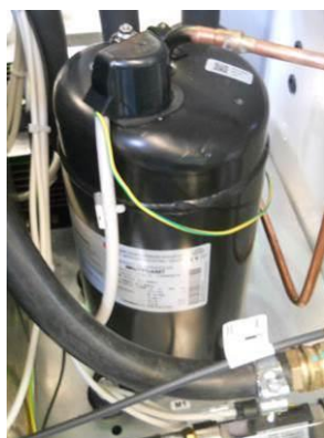
Figura 21 – Posizione del compressore
