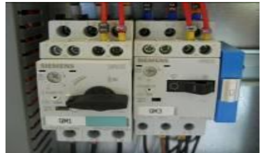
Figura 8 – Interruttori di circuito OFF
