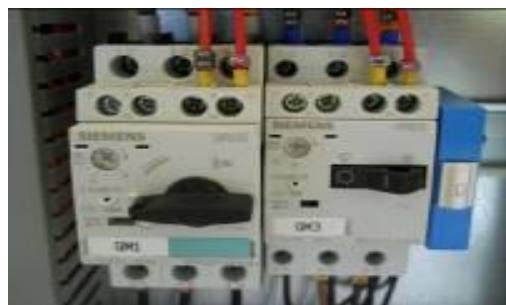
Figura 8 – Interruttori di circuito OFF
