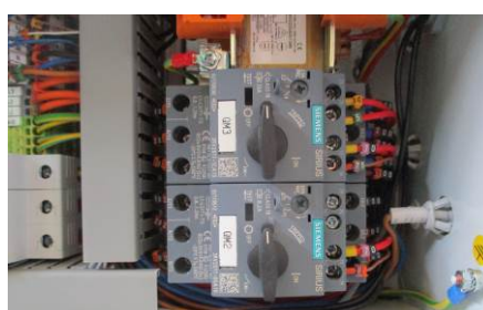
Figura 8 – Interruttori di circuito OFF
