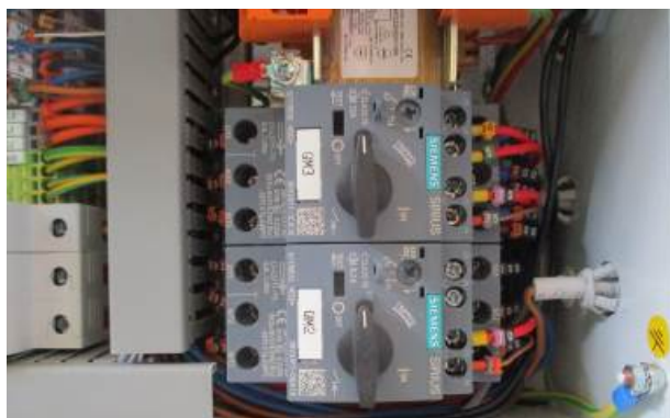
Figura 12 – Interruttore della pompa su ON
