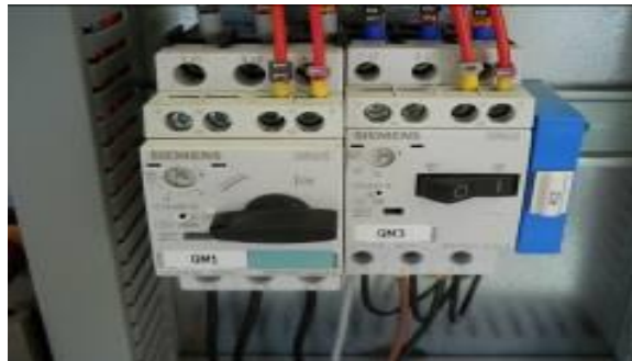
Figure 15 – Interrupteur de la pompe sur ON
