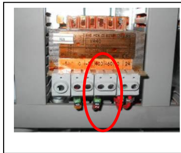
Abbildung 5 Auf 400V eingestellter Transformator
