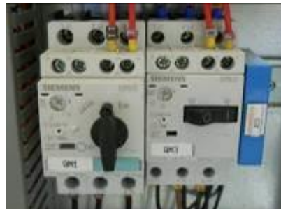
Abbildung 19 – Alle Trennschalter auf ON
