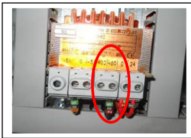
Рис. 6 Трансформатор с 460 В
