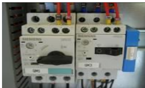
Figura 8 – Interruttori di circuito OFF
