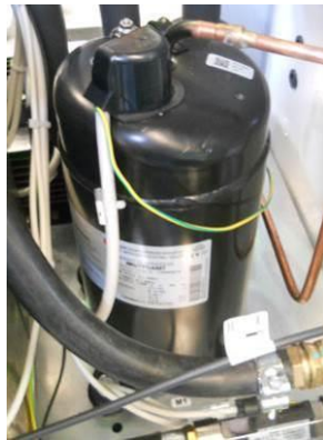
Figura 21 – Posizione del compressore
