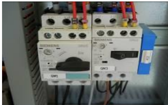
Figura 15 – Interruttore della pompa su ON
