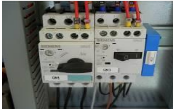
Figura 15 – Interruptor de la bomba en ON
