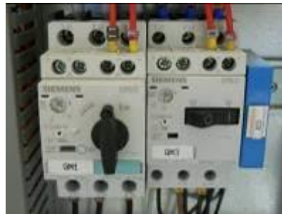
Figure 19 – Tous les interrupteurs de circuit sur ON
