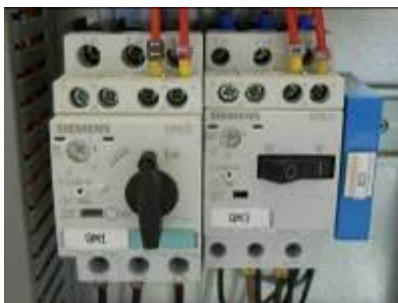
Figura 19 – Interruptores del circuito en ON
