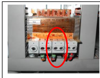
Рис. 5 Трансформатор с 400 В
