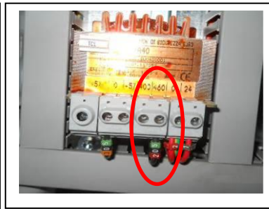
Abbildung 6 Auf 460V eingestellter Transformator
