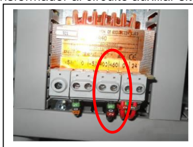
Figura 6 Transformador config. en 460 V
