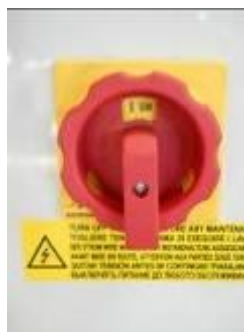
Figura 16 – Interruttore generale su ON
