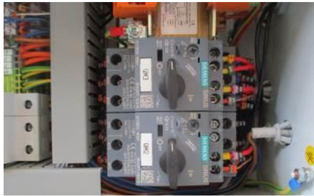
Figura 12 – Interruttore della pompa su ON
