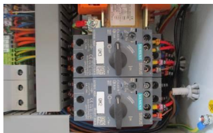
Figura 8 – Interruttori di circuito OFF
