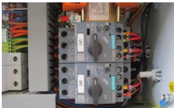
Figure 12 – Interrupteur de la pompe sur ON
