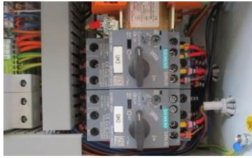
Figura 12 – Interruptor de la bomba en ON
