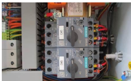
Figura 8 – Interruptores del circuito OFF
